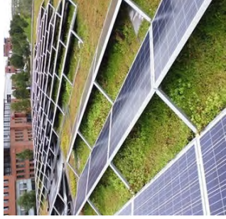
groen dak met zonnepanelen
