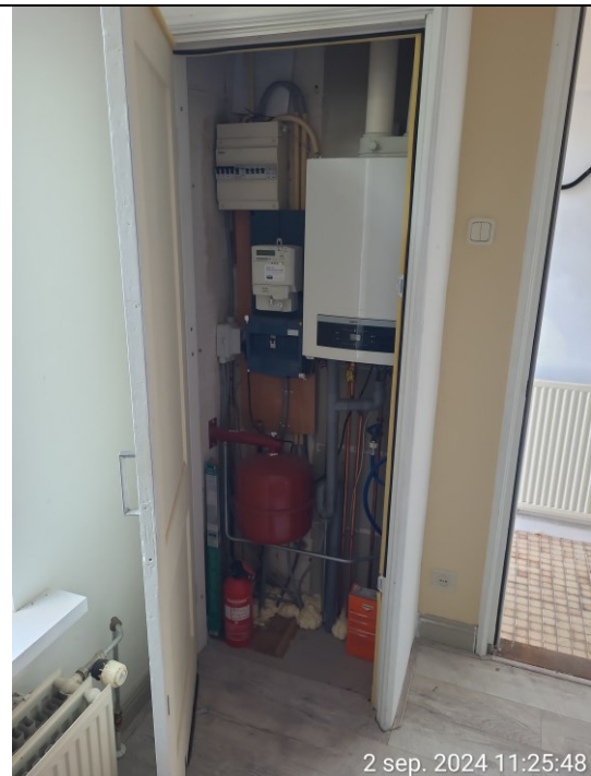
Meterkast met CV-ketel aan de voorgevel
