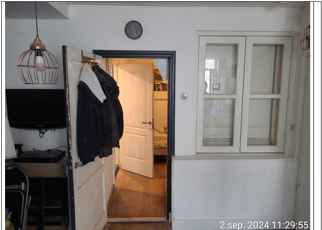
Rechtsboven op foto de rookmelder en deur naar achtergelegen slaapkamer zonder daglicht.
